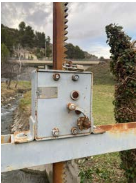
Photo 5 : la vanne gauche
